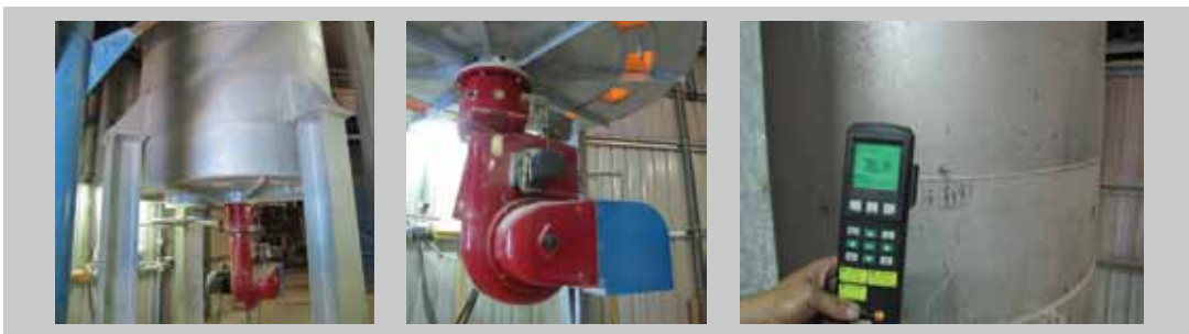
圖1 熱風乾燥爐經位移改善後外觀及天然氣燃燒機與爐壁溫度量測值
